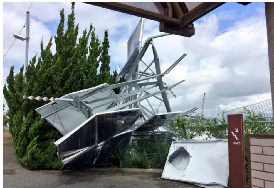
2018年7月 台風12号(静岡県湖西市)
